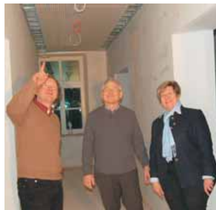
Architekt Max Bortenschlager (links) unterrichtete Vize-Bürgermeisterin Hannelore Langwieser und Stadtbaumeister Sebastian Ecker, der auch Geschäftsführer der Betriebs- und Entwicklungsgesellschaft Mainburg (BEM) ist, über den Fortgang der Bauarbeiten im Uraltbau des Krankenhauses (Foto: Bruckmeier).
